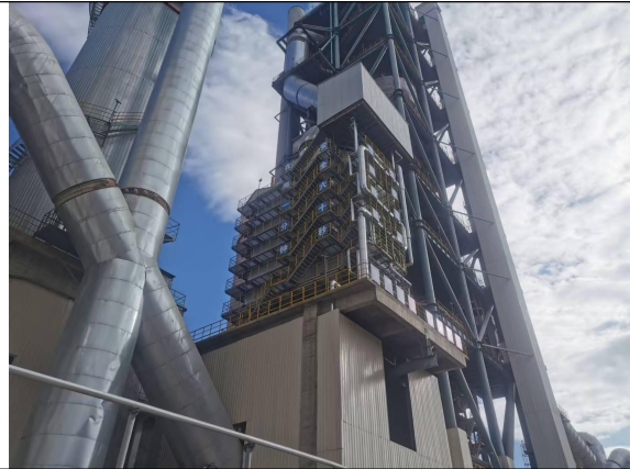
窑尾余热锅炉
