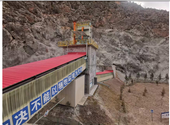
矿石输送封闭廊道和转载点除尘器
