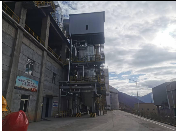
窑头余热锅炉
